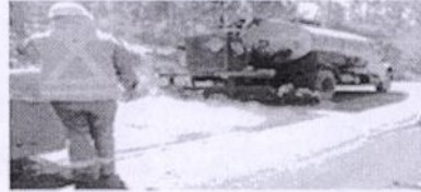
Imprimación: Consiste en la aplicación por medio de S-Prime (material asfáltico) que impermeabiliza la base y sirve como adhesivo entre esta y el negro asfáltico.
