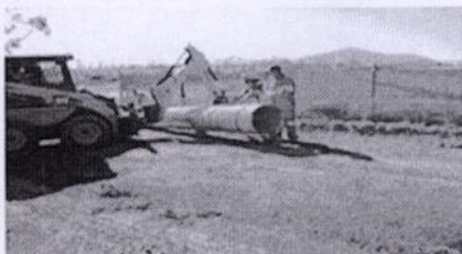
Apoyo de maquinaria Minicargador para la instalación de Alcantarilla Tubo Metal Corrugado
